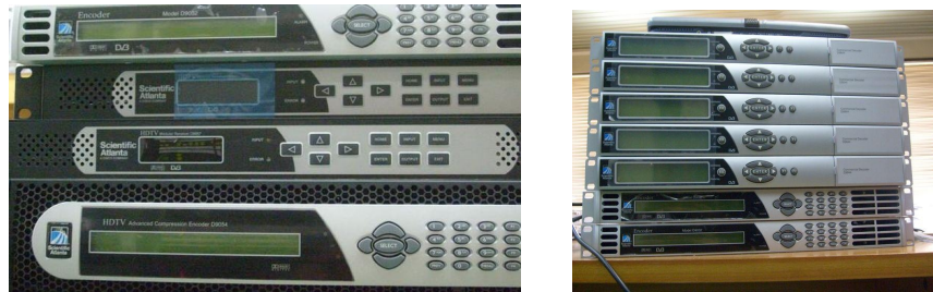
Slika 3.3. DVB enkoderi u terminalu na Košutnjaku.
